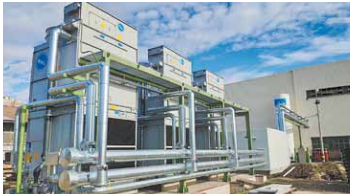
A Fémbevonóműben telepített gyors hűtőberendezések, az úgynevezett rapid jet coolerek vízhűtőtornyai
