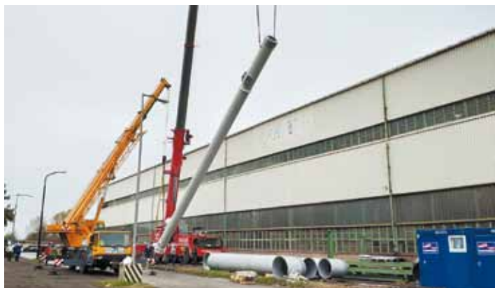
Látványos művelet volt a beruházás során a 19 méter magas, 4 tonna súlyú kémény darus emelése
